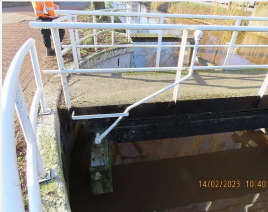
Aandrijving en bewegingswerk (mechanisch) - Aandrijving en bewegingswerk (mechanisch), Algemeen (1)
