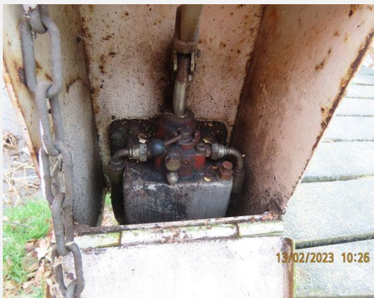
Aandrijving en bewegingswerk (elektrohydraulisch) - Hydraulisch aggregaat (1)
