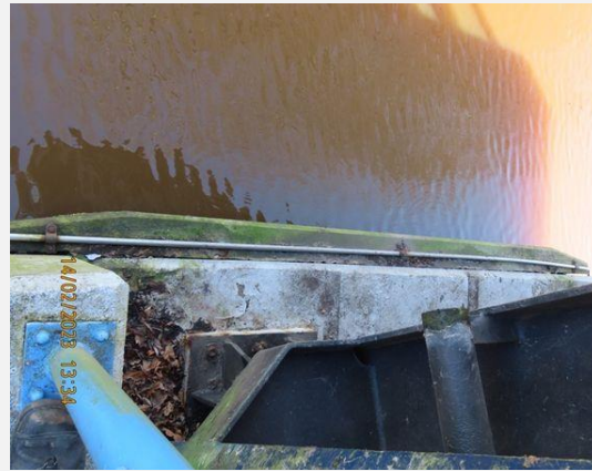
Kabeldraagconstructie - Kabeldraagconstructie, Algemeen (1)
