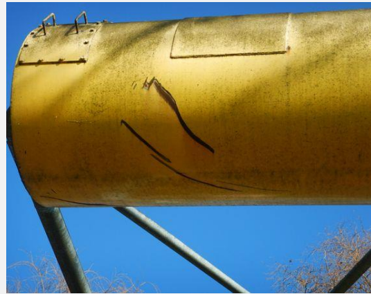
Hoofddraagconstructie (Staal) - Contragewicht
