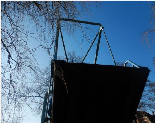
Hoofddraagconstructie (Staal) - Beschermlaag
