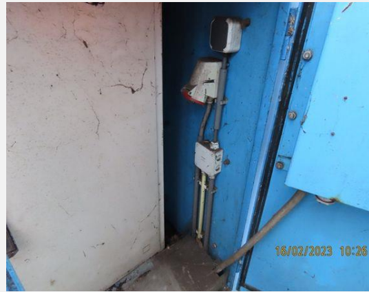
Laagspanningsinstallatie - Laagspanningsinstallatie, Algemeen (1)
