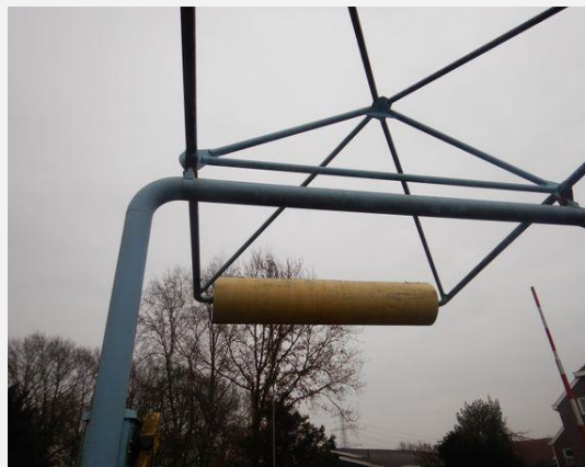
Hoofddraagconstructie (Staal) - Beschermlaag
