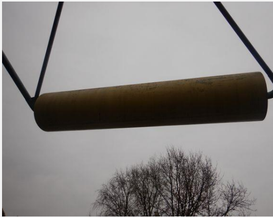
Hoofddraagconstructie (Staal) - Contragewicht
