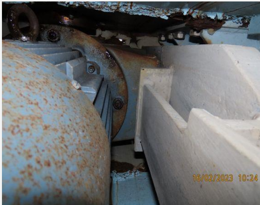
Aandrijving en bewegingswerk (elektromechanisch) - Reductiekast (1)
