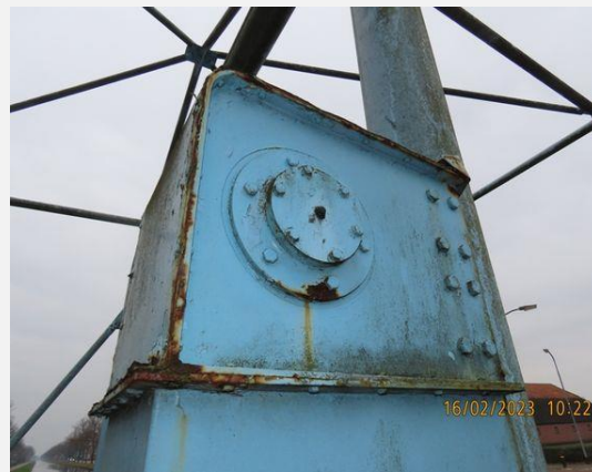
Aandrijving en bewegingswerk (elektromechanisch) - Frame (1)
