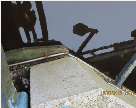
Kabeldraagconstructie - Kabeldraagconstructie, Algemeen (1)
