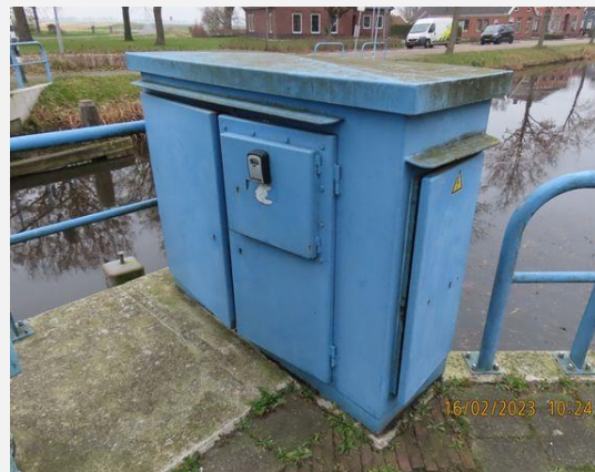
Bedienings- en besturingsinstallatie - Kast (1)
