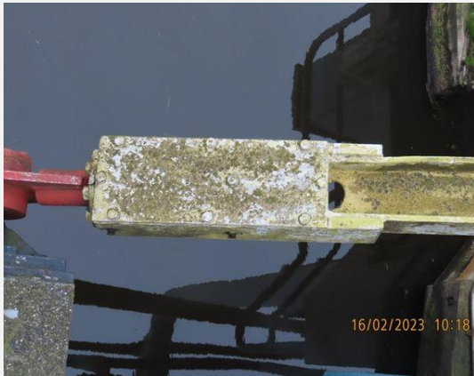
Aandrijving en bewegingswerk (elektromechanisch) - Buffer (1)
