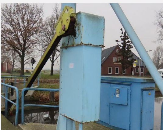
Aandrijving en bewegingswerk (elektromechanisch) - Beschermconstructie (1)
