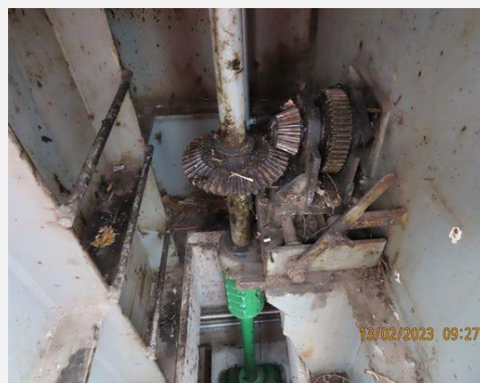
Aandrijving en bewegingswerk (elektromechanisch) - Noodhandbediening (1)
