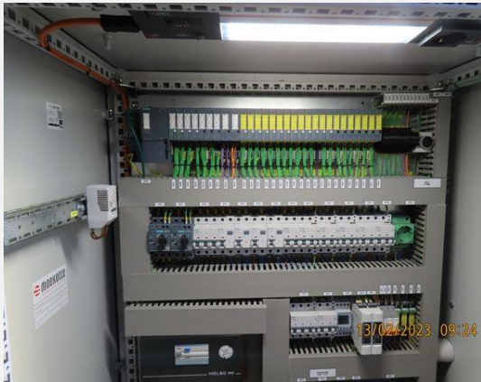
Bedienings- en besturingsinstallatie - Programmable Logic Controller (PLC) ( 1 )
