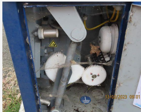
Afsluitboominstallatie - Afsluitboominstallatie, Algemeen ( 4 )
