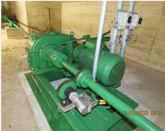
Aandrijving en bewegingswerk (elektromechanisch) - Aandrijving en bewegingswerk (elektromechanisch), Assen (1)
