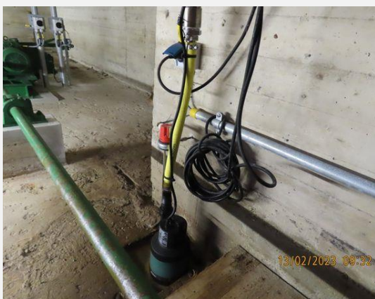
Pompinstallatie - Pompinstallatie, Algemeen (1)
