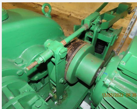
Aandrijving en bewegingswerk (elektromechanisch) - Rem (1)
