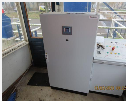
Bedienings- en besturingsinstallatie - Kast (1)
