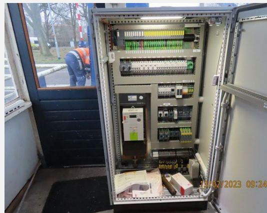
Bedienings- en besturingsinstallatie - Bedienings- en besturingssysteem, Algemeen (1)
