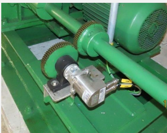
Aandrijving en bewegingswerk (elektromechanisch) - Toerenregelinstantie (1)
