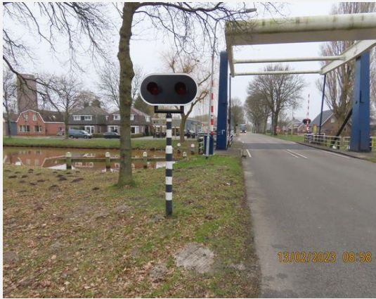
Verkeersregelinstallatie (VRI) - Landverkeerssein (7)
