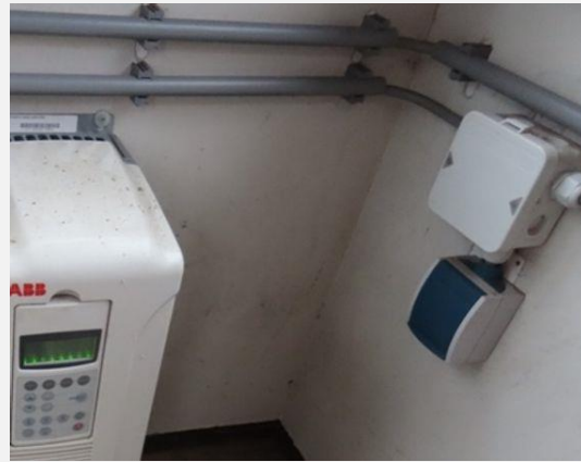
Laagspanningsinstallatie - Laagspanningsinstallatie, Algemeen (1)
