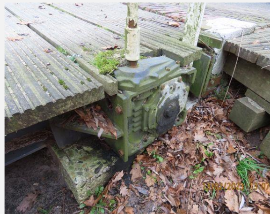
Aandrijving en bewegingswerk (mechanisch) - Reductiekast (1)
