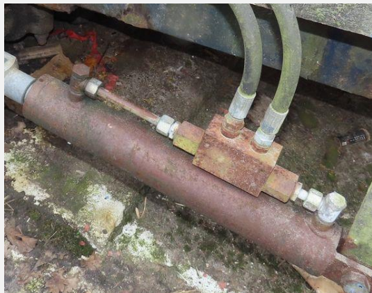
Aandrijving en bewegingswerk (elektrohydraulisch) - Buisleiding (1)
