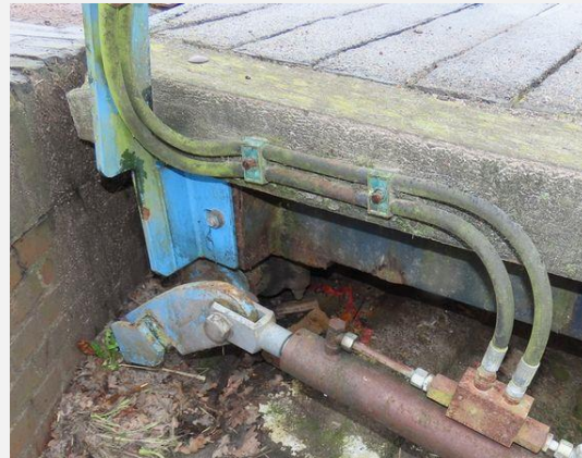
Aandrijving en bewegingswerk (elektrohydraulisch) - Buisleiding (2)
