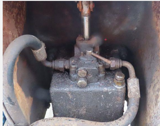
Aandrijving en bewegingswerk (elektrohydraulisch) - Appendage (1)
