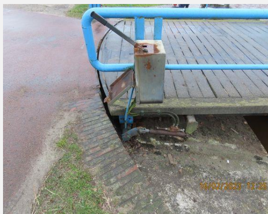
Aandrijving en bewegingswerk (elektrohydraulisch) - Kast (1)
