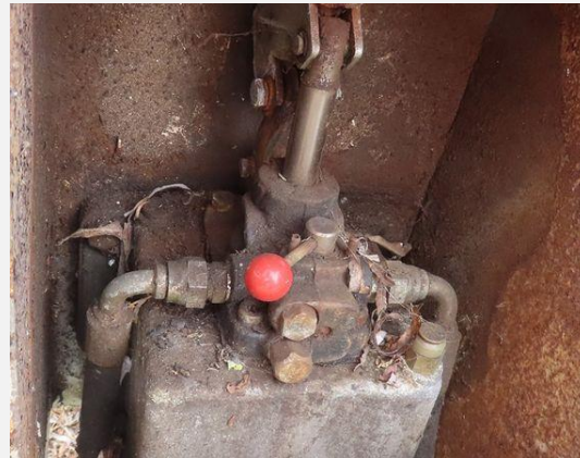
Aandrijving en bewegingswerk (elektrohydraulisch) - Appendage (1)
