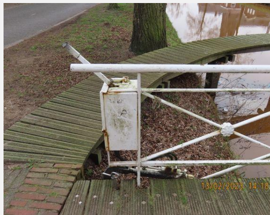
Aandrijving en bewegingswerk (elektrohydraulisch) - Kast (1)
