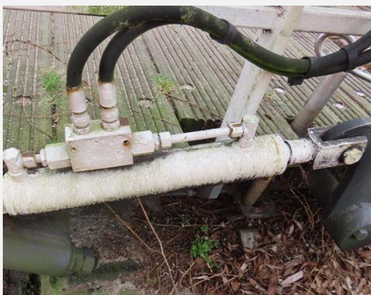
Aandrijving en bewegingswerk (elektrohydraulisch) - Buisleiding (1)
