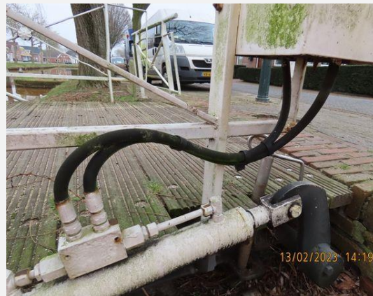
Aandrijving en bewegingswerk (elektrohydraulisch) - Buisleiding (2)
