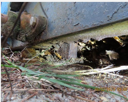
Aandrijving en bewegingswerk (mechanisch) - Opzetinrichting (2)
