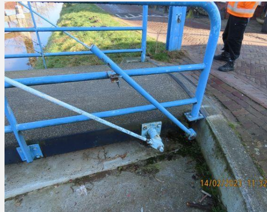
Aandrijving en bewegingswerk (mechanisch) - Aandrijving en bewegingswerk (mechanisch), Algemeen (4)
