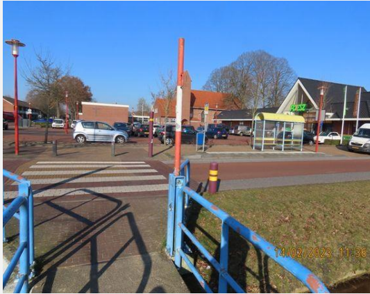
Afsluitboominstallatie - Afsluitboominstallatie, Algemeen (2)
