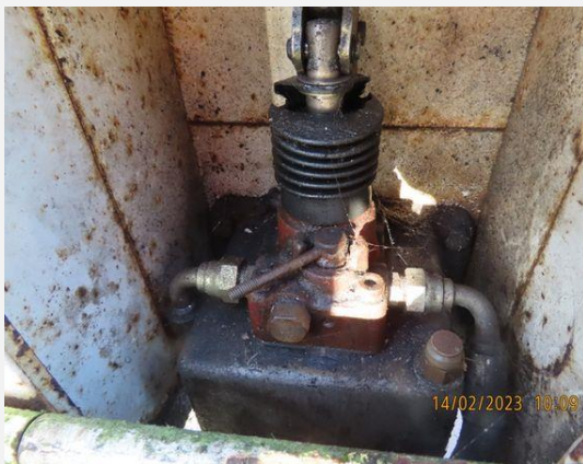
Aandrijving en bewegingswerk (elektrohydraulisch) - Hydraulisch aggregaat (1)
