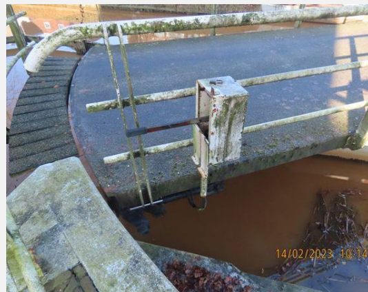
Aandrijving en bewegingswerk (elektrohydraulisch) - Kast (1)
