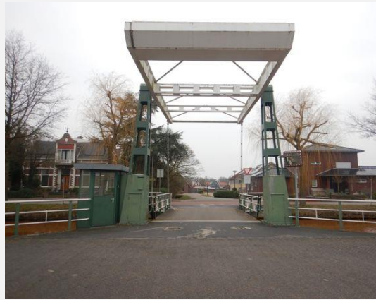
Hoofddraagconstructie (Staal) - Contragewicht
