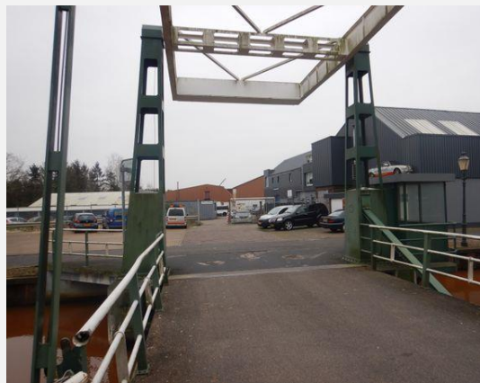
Hoofddraagconstructie (Staal) - Beschermlaag
