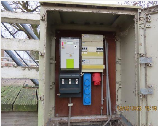
Laagspanningsinstallatie - Laagspanningsinstallatie, Algemeen (1)
