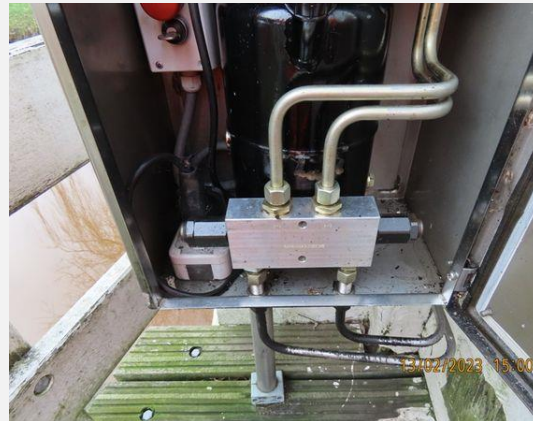
Aandrijving en bewegingswerk (elektrohydraulisch) - Appendage (1)
