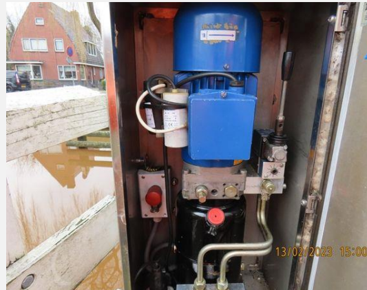
Aandrijving en bewegingswerk (elektrohydraulisch) - Buisleiding (4)
