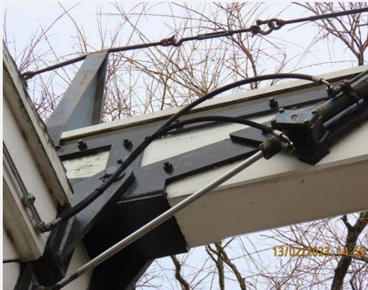
Aandrijving en bewegingswerk (elektrohydraulisch) - Buisleiding (4)
