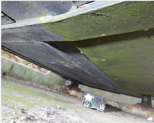
Hoofddraagconstructie (Staal) - Contragewicht
