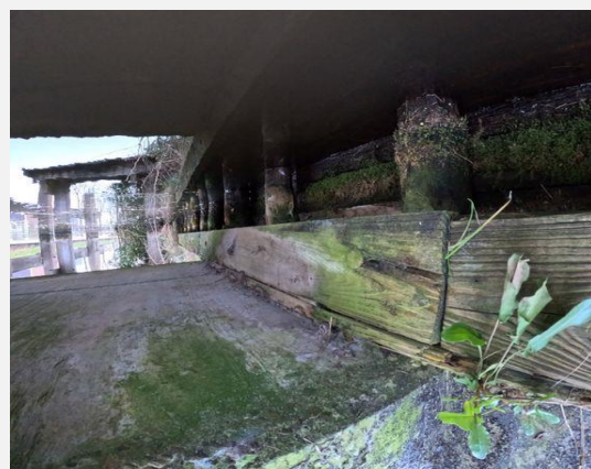
Kerende constructie - Beschoeiing
