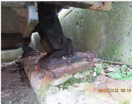
Aandrijving en bewegingswerk (mechanisch) - Opzetinrichting (2)
