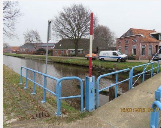
Afsluitboominstallatie - Afsluitboominstallatie, Algemeen (1)
