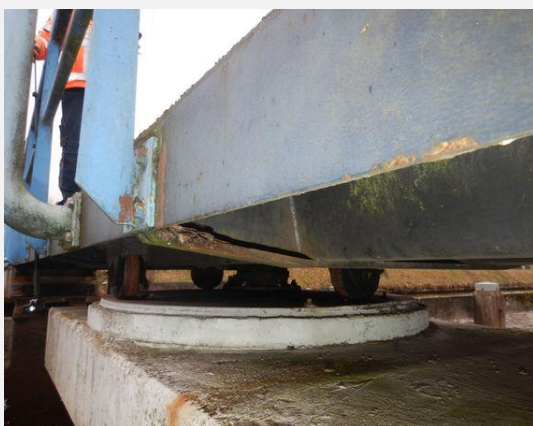
Hoofddraagconstructie (Staal) - Beschermlaag
