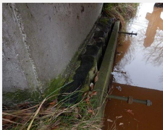
Kerende constructie - Beschoeiing
