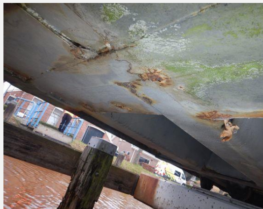
Hoofddraagconstructie (Staal) - Beschermlaag
