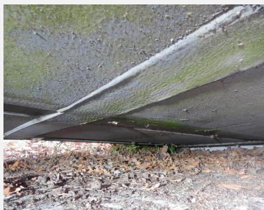
Hoofddraagconstructie (Staal) - Contragewicht
