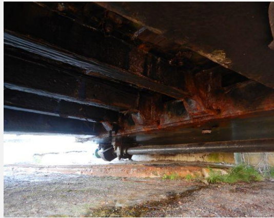
Hoofddraagconstructie (Staal) - Beschermlaag
