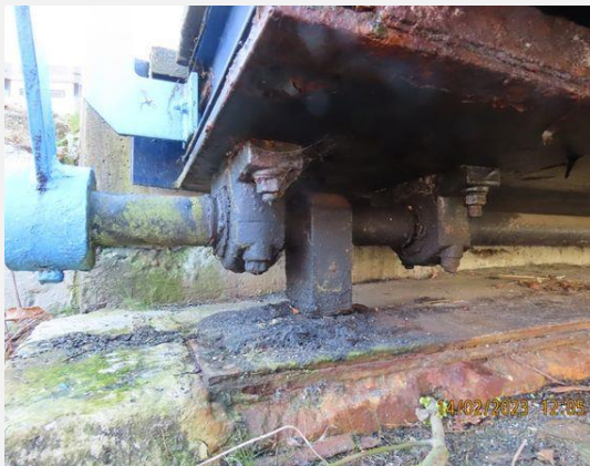
Aandrijving en bewegingswerk (mechanisch) - Opzetinrichting (2)
