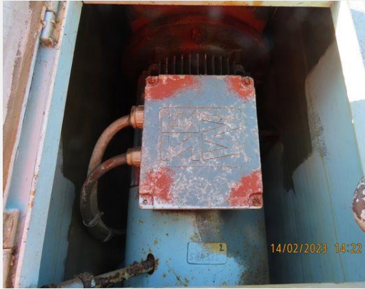
Aandrijving en bewegingswerk (elektromechanisch) - Elektromotor (1)
