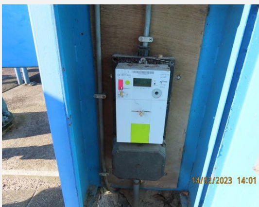
Laagspanningsinstallatie - Laagspanningsinstallatie, Algemeen (1)
