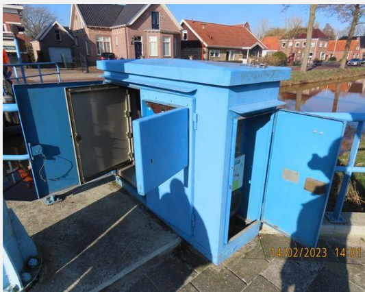
Bedienings- en besturingsinstallatie - Kast (1)
