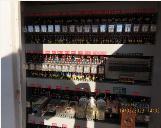
Bedienings- en besturingsinstallatie - Bedienings- en besturingssysteem, Algemeen (1)
