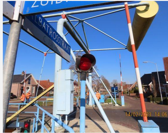
Verkeersregelininstallatie (VRI) - Verkeersregelininstallatie (VRI), Algemeen (4)
