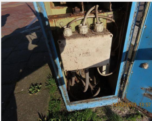
Afsluitboominstallatie - Afsluitboominstallatie, Algemeen (4)
