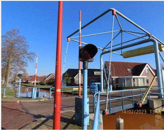
Verkeersregelininstallatie (VRI) - Mast (4)
