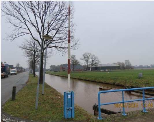
Afsluitboominstallatie - Afsluitboominstallatie, Algemeen (1)
