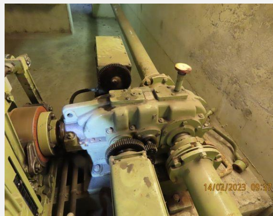
Aandrijving en bewegingswerk (elektromechanisch) - Reductiekast (3)
