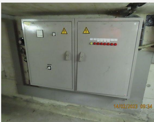
Bedienings- en besturingsinstallatie - Kast (1)
