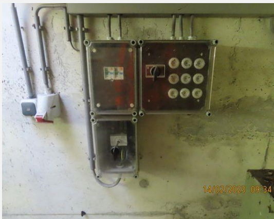
Laagspanningsinstallatie - Laagspanningsinstallatie, Algemeen (1)
