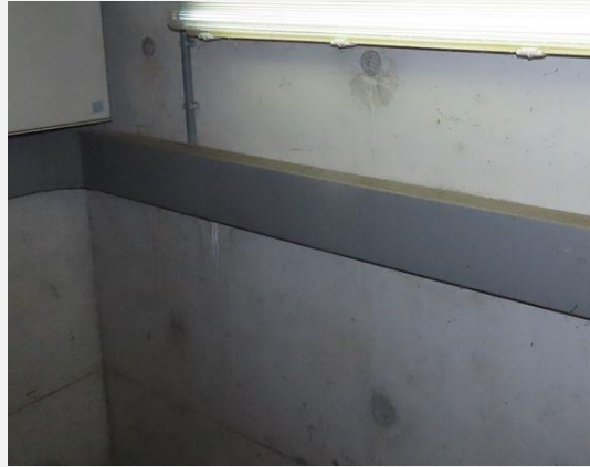
Kabeldraagconstructie - Kabeldraagconstructie, Algemeen (1)
