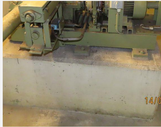
Aandrijving en bewegingswerk (elektromechanisch) - Frame (3)
