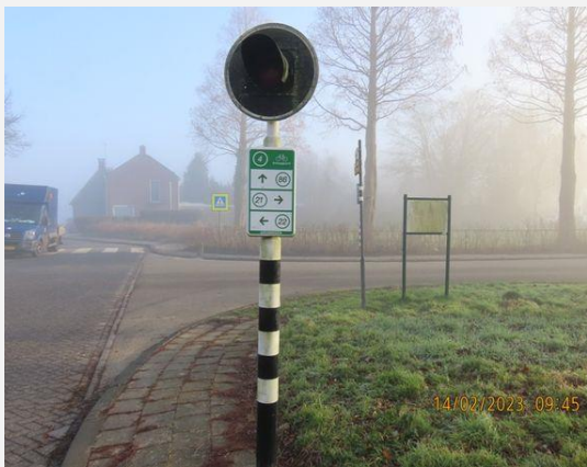
Verkeersregelinstallatie (VRI) - Beschermlaag (6 )
