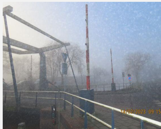
Afsluitboominstallatie - Afsluitboominstallatie, Algemeen (4)
