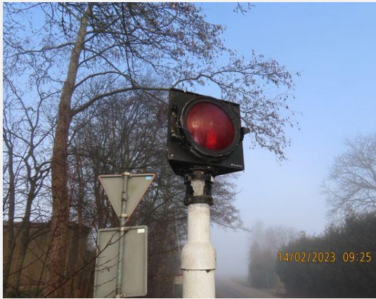
Verkeersregelinstallatie (VRI) - Landverkeerssein (6 )
